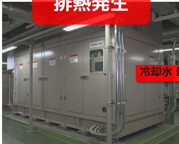
450kW ガスエンジン コージェネレーション
